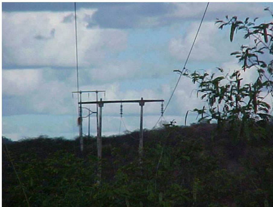
Foto 12-023 – Linha em Postes de Concreto
